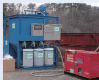
建設現場排水処理 一体型装置
